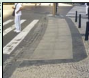
Figura 333 – Demarcação, com piso tátil, da existência de rampa que compõe a rota acessível.
