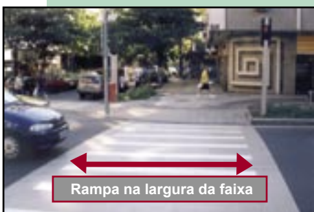
Figura 310 – A largura da rampa deve dar preferência para compreender a mesma largura da faixa de travessia e suas abas laterais poderão ser eliminadas quando houver algum outro tipo de obstáculo.
