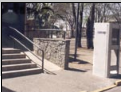
Figura 074 - Erro na definição da inclinação da rampa.
