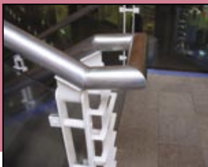
Figura 329 – Corrimão contínuo conforme recomenda a NBR, porém as quinas vivas resultantes da execução do mesmo podem causar acidentes.
