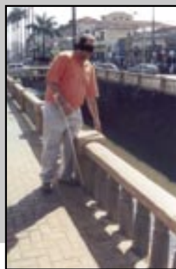
Figura 124 - Mureta de proteção de rio baixa demais, podendo provocar acidentes.
