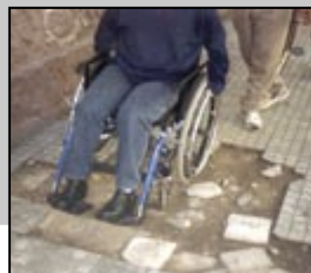
Figura 075 - Falta de manutenção do piso da calçada.
