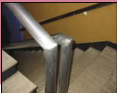
Figura 328 – Corrimão descontínuo provoca a perda de equilíbrio em diversas pessoas pela interrupção do apoio. No caso das Rotas de Fuga esta situação é perigosa.
