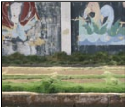
Figura 101 - Calçada descontínua, com grama, intermediando placas de cimento, dificultando a circulação.
