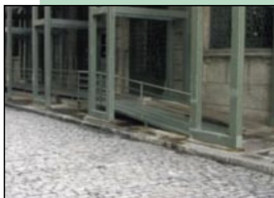
Figuras 131 - Rampa metálica removível, acoplada a edificação histórica para não se descaracterizar a edificação e permitir o acesso de usuários de cadeiras de rodas.
